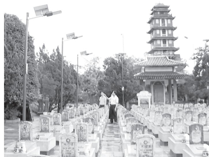
Trụ đèn năng lượng mặt trời được lắp đặt tại Khu A, Nghĩa trang liệt sĩ Khe Sanh
