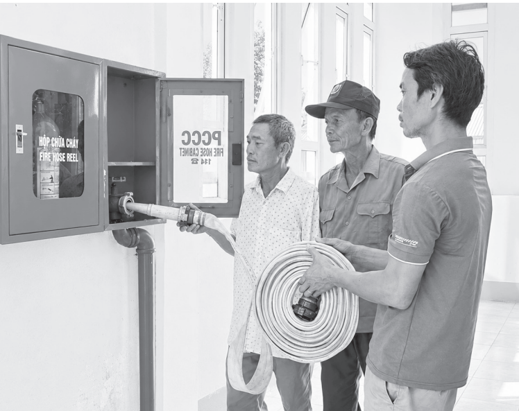
Lãnh đạo Ban quản lý chợ Mỹ Chánh kiểm tra thiết bị chữa cháy - Ảnh: N.V
