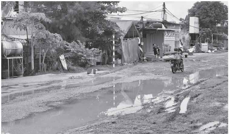
Đường Nguyễn Hữu Cánh qua địa bàn tổ dân phố Thọ Đơn bị hư hỏng, xuống cấp nghiêm trọng
