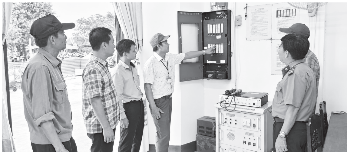
Lãnh đạo Ban Quản lý chợ kiểm tra thiết bị phòng cháy, chữa cháy tại chợ Đông Hà
