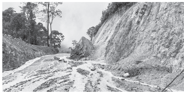
Nhiều tuyến đường bị sạt lở do ảnh hưởng của mưa lớn - Ảnh: P.V
