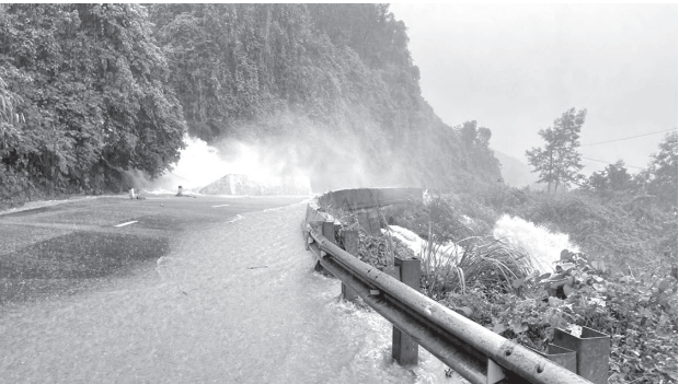
Tại Quốc lộ 14, đoạn từ Km22 đến km30 bị sạt lở, nước tràn ngập đường rất nguy hiểm - Ảnh: CTV
