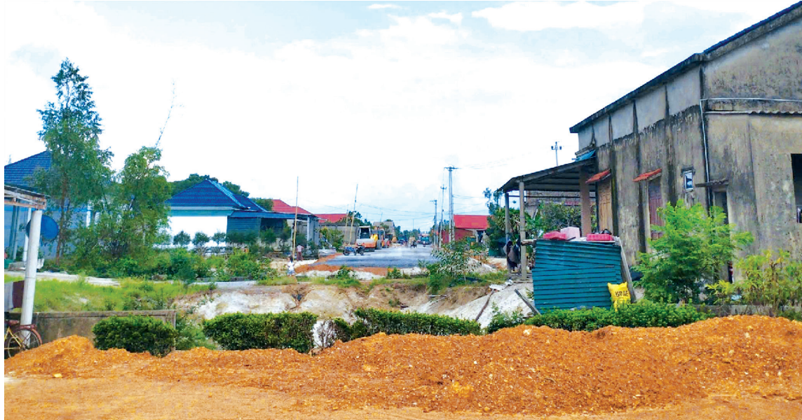
Công trình ngừng thi công do chưa giải phóng được mặt bằng tại xã Sen Ngự
