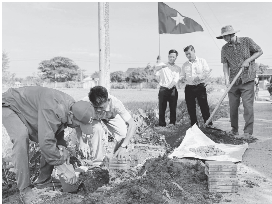
Người dân xã Cửa Việt chung sức xây dựng hạ tầng nông thôn - Ảnh: ỦY BAN MTTQVN XÃ CỬA VIỆT
