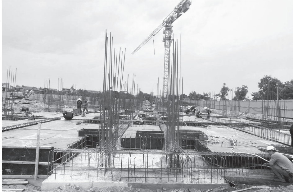
Đơn vị thi công đang tích cực đẩy nhanh tiến độ dự án Khu nhà ở xã hội trung tâm TP. Đông Hới-Tây Bắc đường Lê Lợi
