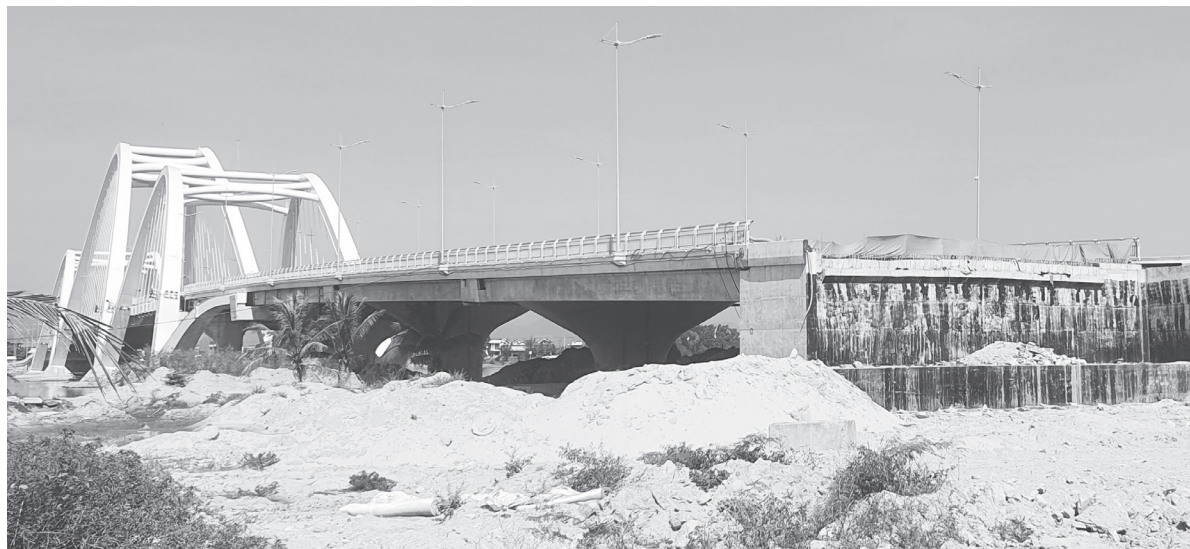
Do vướng mặt bằng nên hạng mục tuyến đường dẫn vào đầu cầu phía Đông chưa thể thi công
