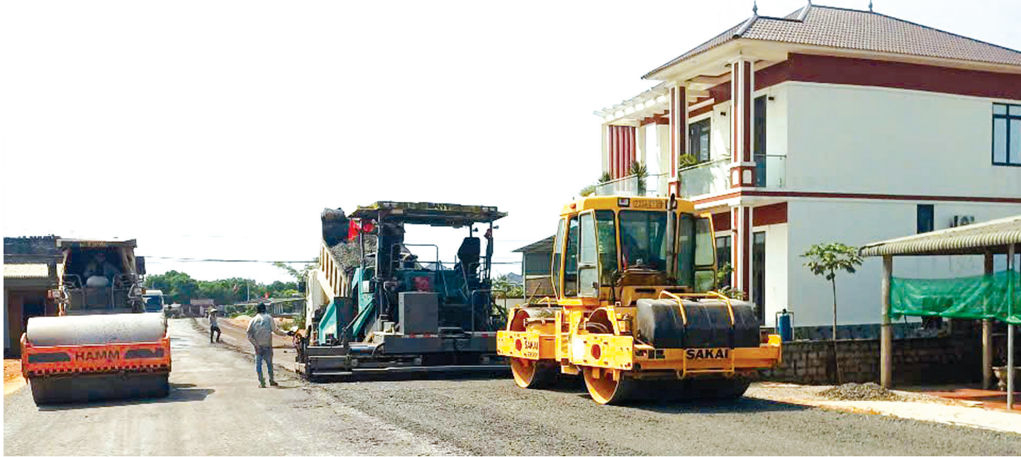
Nhà thầu Tập đoàn Trường Thịnh “tăng ca, tăng kíp” thi công gói thầu đoạn qua địa bàn xã Sen Ngư - Ảnh: B.T
