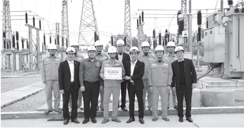
Nhiều công trình điện quan trọng được PC Quảng Trị đưa vào sử dụng, đáp ứng nhu cầu phụ tải ngày càng tăng
