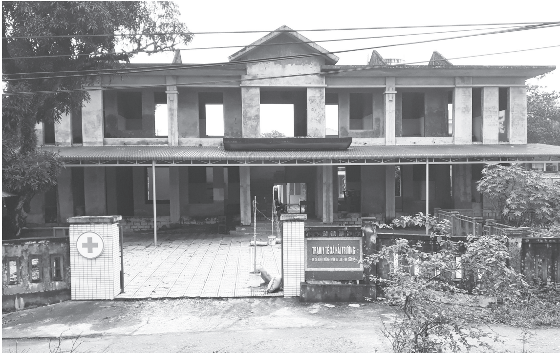
Dự án Trạm Y tế Hải Trường, xã Diên Sanh ngừng thi công kéo dài
