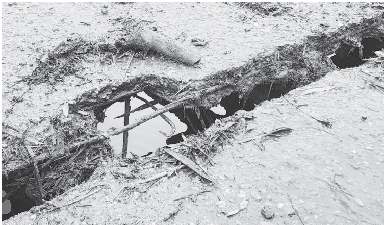
Mặt cầu Bến Làng Trâm Lý đã bị lún sụt, hư hỏng
