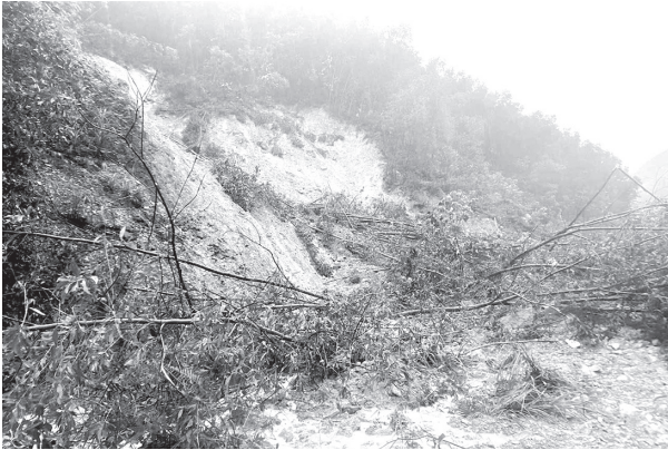
Quốc lộ 9C sạt lở nghiêm trọng do mưa lớn - Ảnh: N.H
