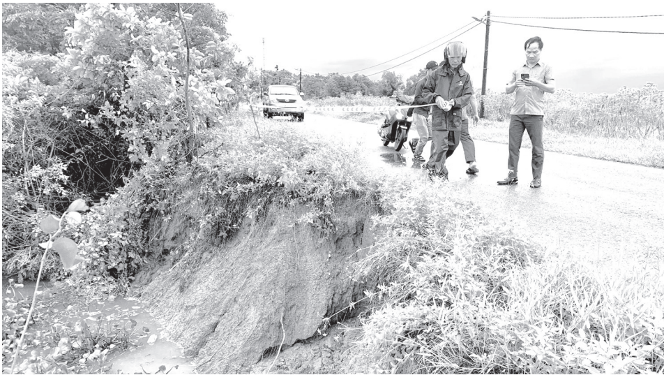
Điểm sạt lở bờ sông Vĩnh Định đoạn qua thôn Lam Thủy mới xuất hiện, tạo hàm ếch lớn phía dưới tuyến đường liên xã huyết mạch Xuân-Quy-Vĩnh - Ảnh: Đ.V
