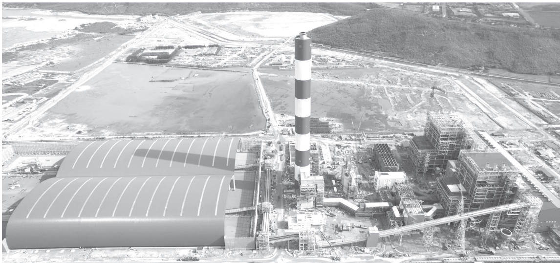
Nhà máy Nhiệt điện Quảng Trạch I công suất 1.403MW sẽ vận hành hai tổ máy, phát điện thương mại trên 80% công suất vào năm 2026 - Ảnh: L.T
