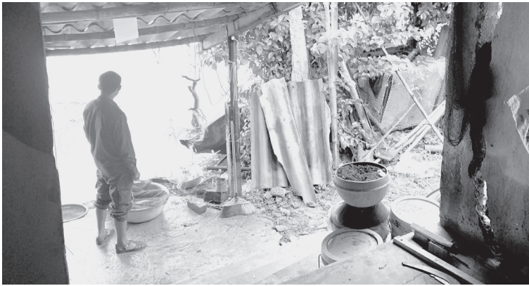
Một số nhà dân (thôn Trà Trì Phú) bị nứt nẻ, sụt lún do sạt lở bờ sông diễn ra ngày càng nghiêm trọng - Ảnh: Đ.V
