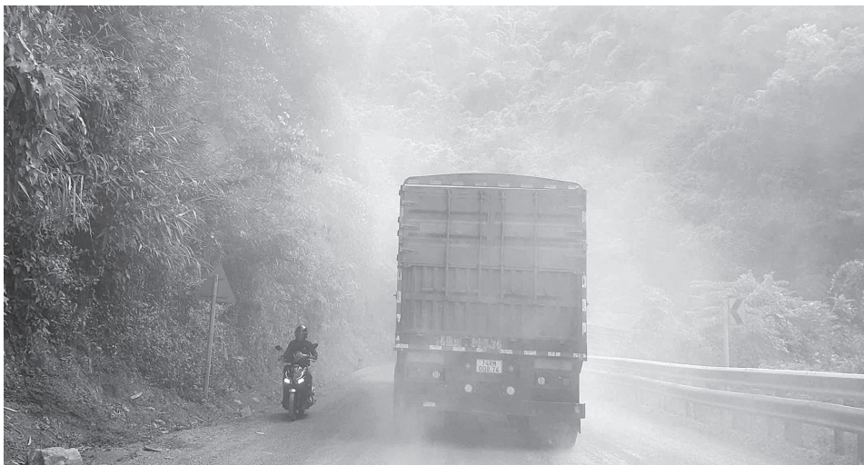
Bụi bao phủ đoạn đường đang được sửa chữa, gây ô nhiễm và tiềm ẩn nguy cơ mất an toàn giao thông - Ảnh: Q.H
