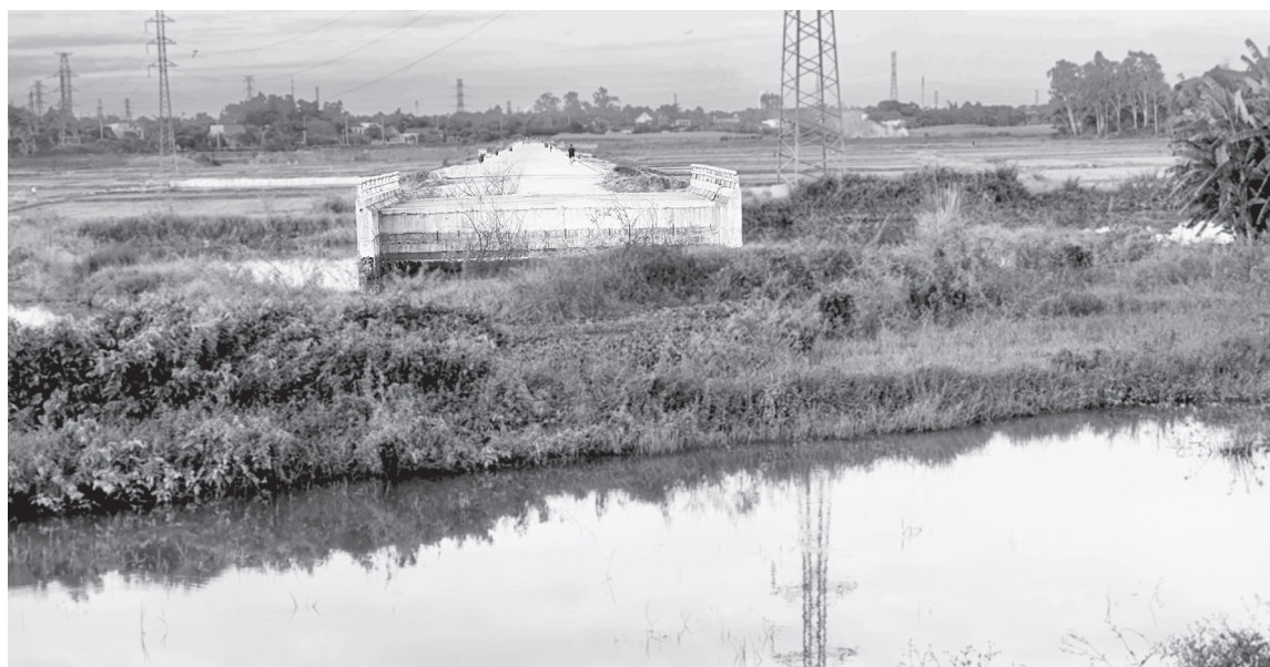
Gói thầu QB03-Đường nối từ đường tránh Quốc lộ 1 với nhánh Đông đường Hồ Chí Minh phải dừng thi công trong thời gian dài do vướng giải phóng mặt bằng -Ảnh: B.T
