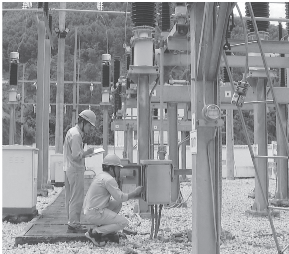
Nhà máy Thủy điện La Trọng đang hoàn tất những khâu cuối cùng để chuẩn bị vận hành vào cuối tháng 8/2025 - Ảnh: H.C
