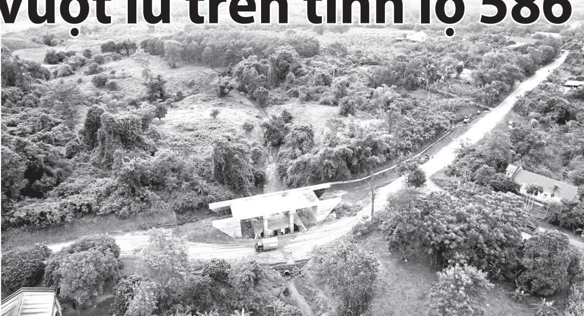
Cầu vượt lũ tại km3+937 tuyến ĐT.586 thuộc thôn Thuận 2, xã Lìa chỉ mới hoàn thành phần cầu, nhiều hạng mục còn đang dở - Ảnh: L.T
